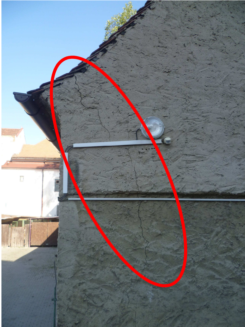
Trhlina na štítové zdi
