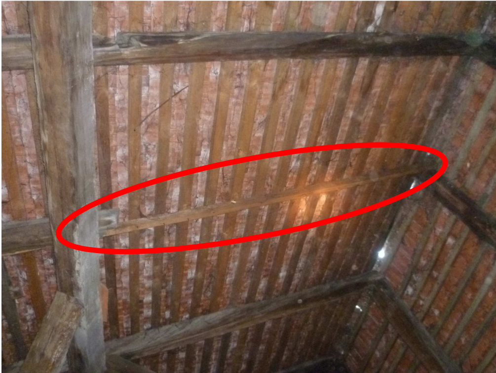
Chybějící krokev. Náhrada v podobě střešní latě je nedostačující.
