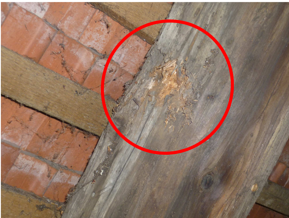
Pravděpodobné poškození dřevokaznými houbami.
