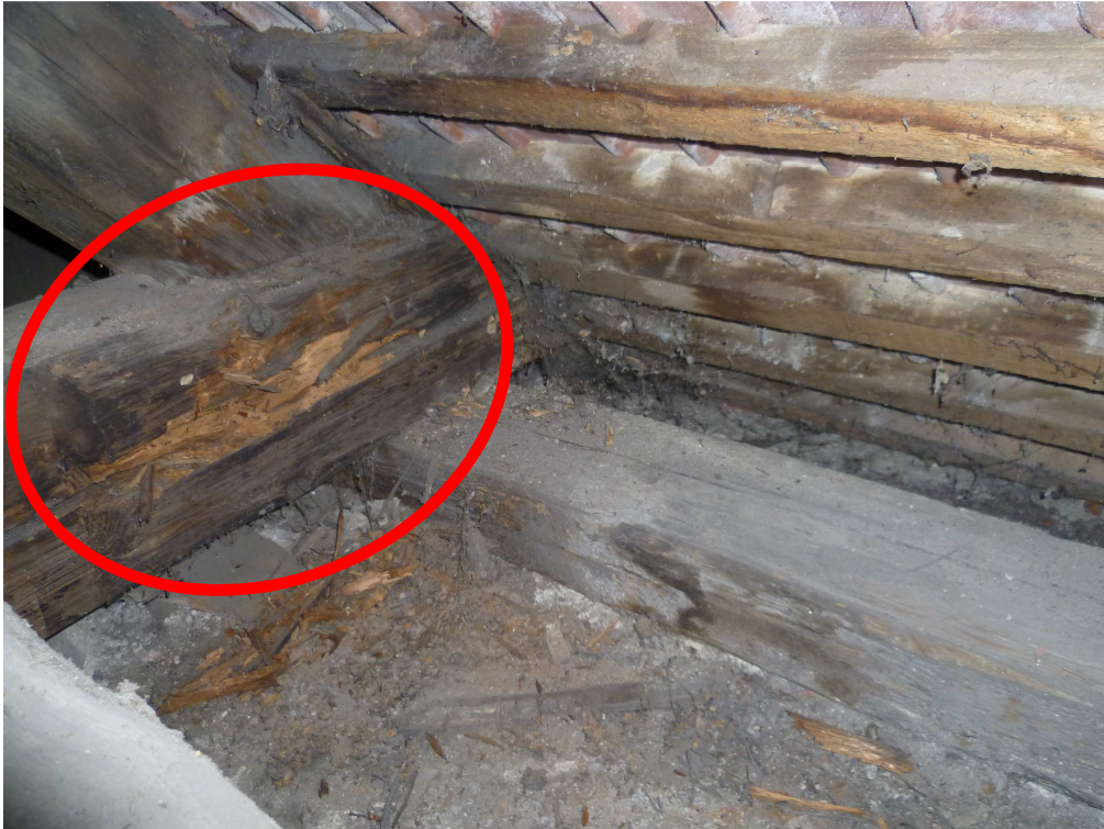
Pravděpodobné poškození dřevokaznými houbami.
