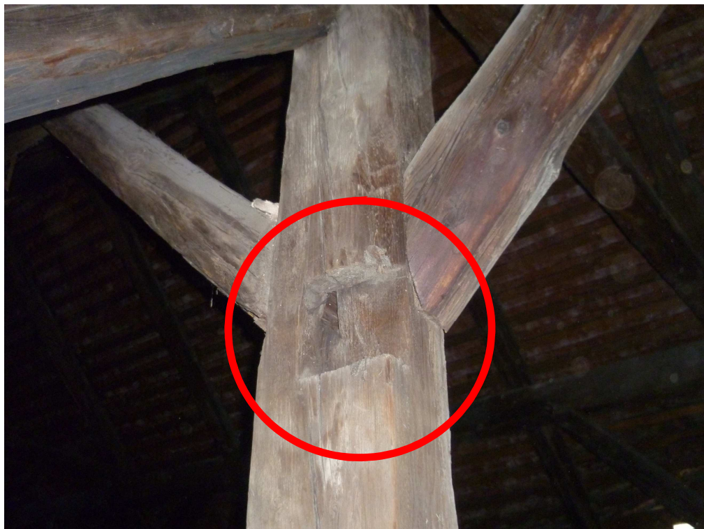
Lokální oslabení sloupku.
