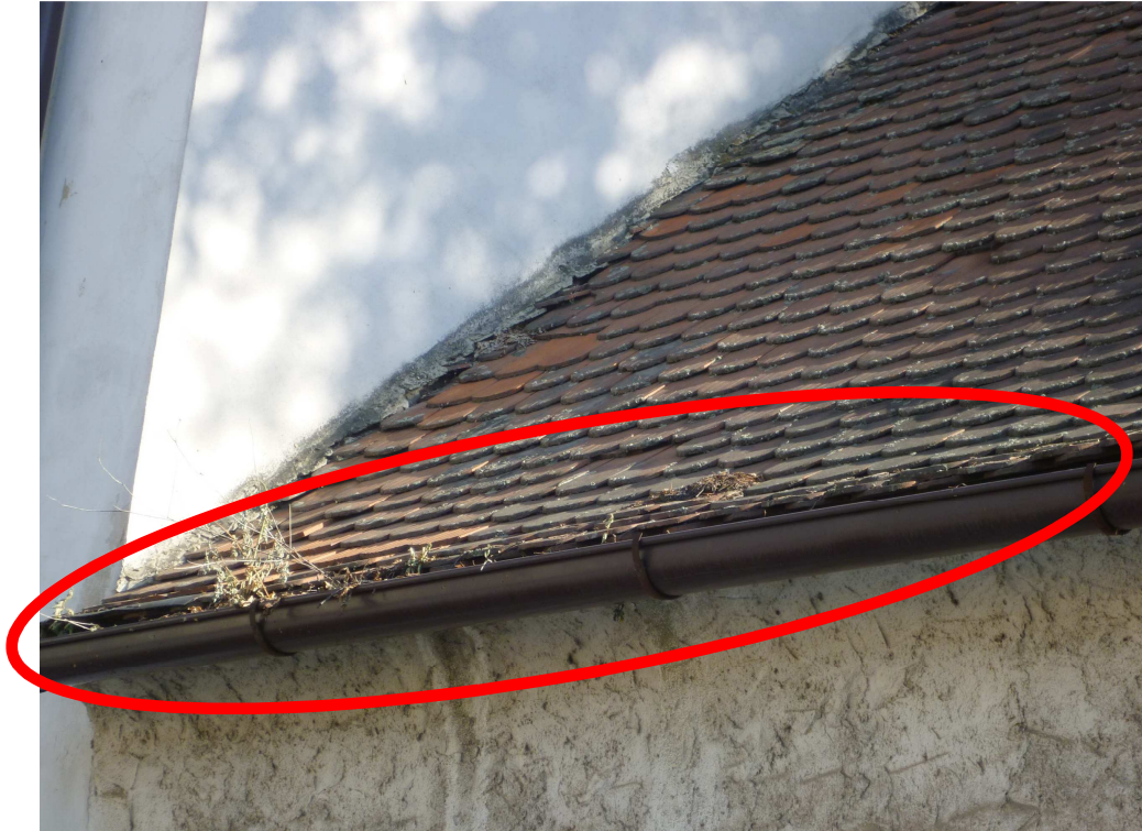
Zanesený okapový žlab
