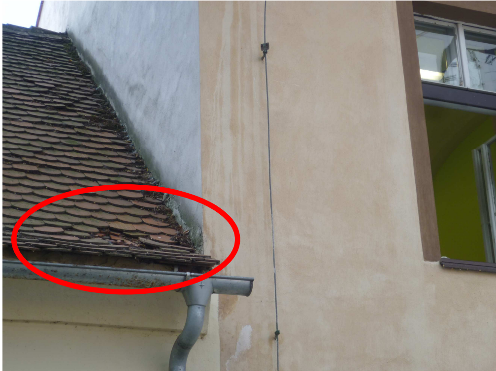
Lokální poškození tašek na střeše
