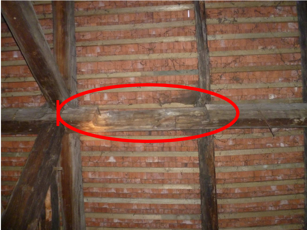
Lokální oslabení vaznice.
