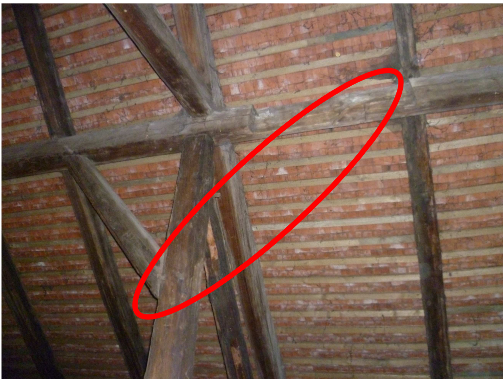
Chybějící pásy v pravé části sloupku.
