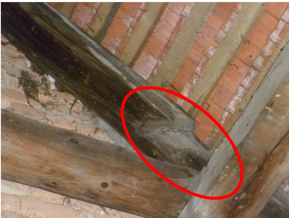
Lokální oslabení krokve.
