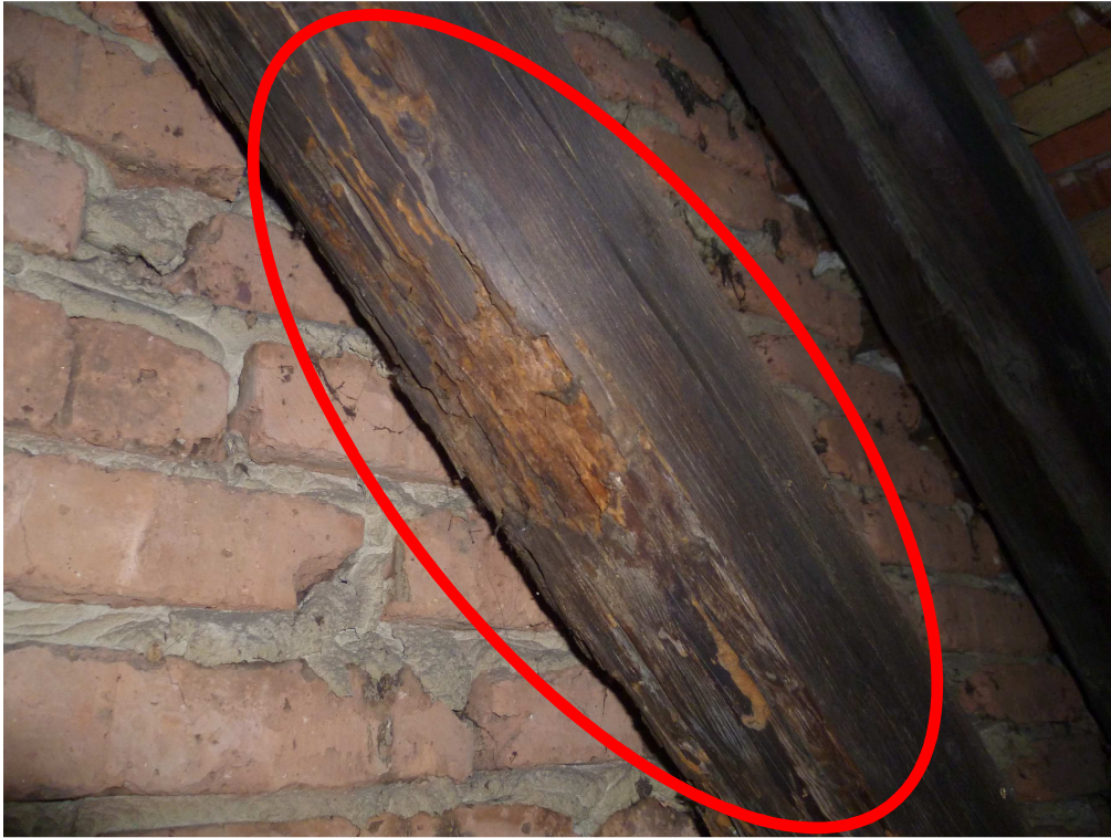
Pravděpodobné poškození dřevokazným hmyzem.
