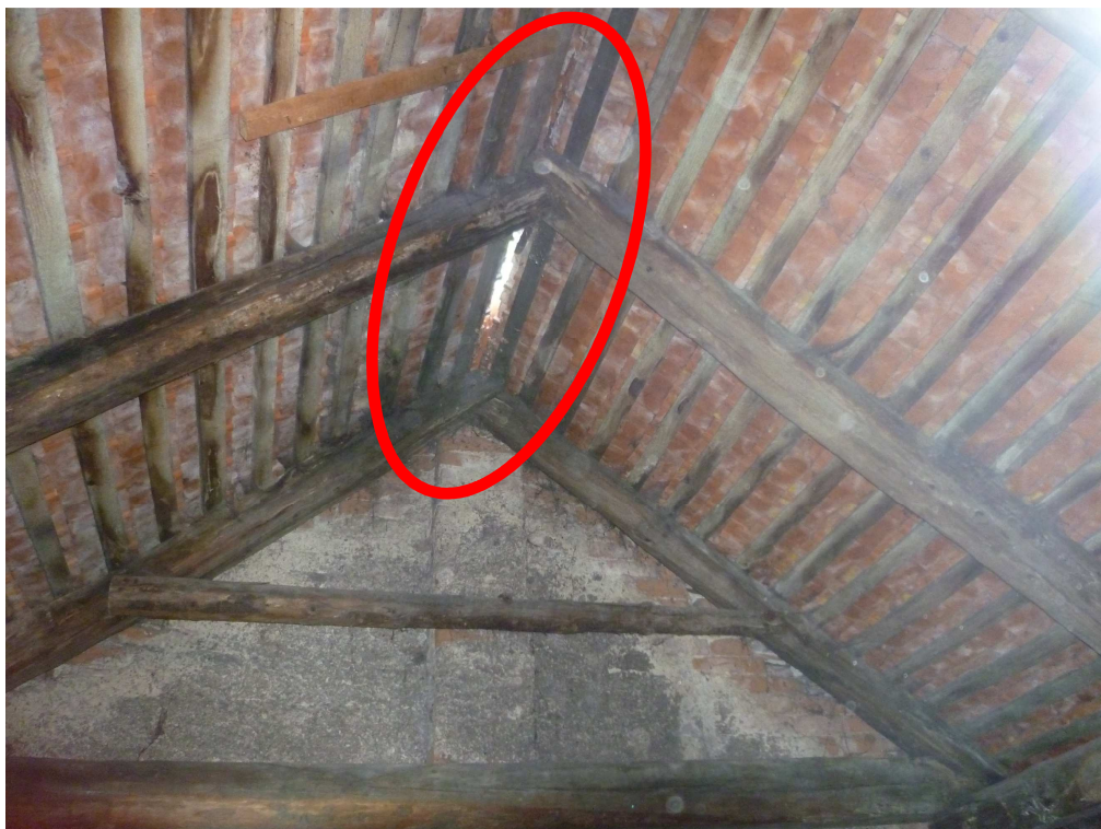
Chybějící a poškozené hřebenové tašky
