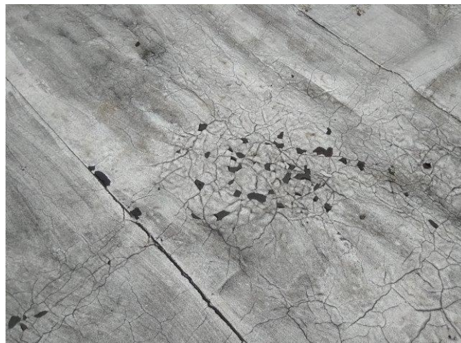
foto /13/ Pohled na popraskaný vrchní asfaltový pás
