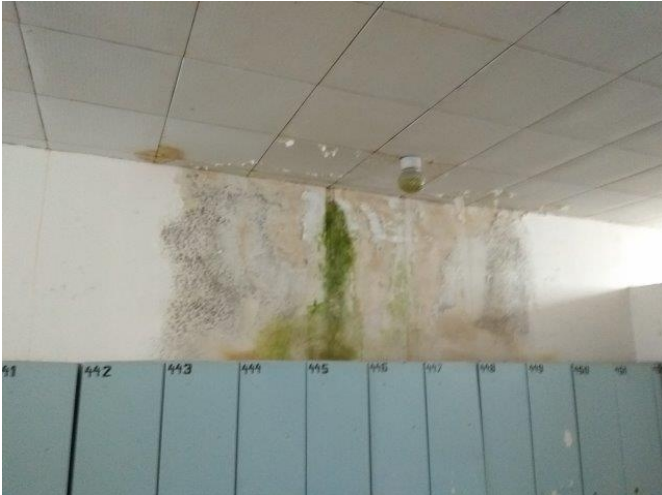
foto /4/ Pohled na vlhkostní poruchy v interiéru šaten
