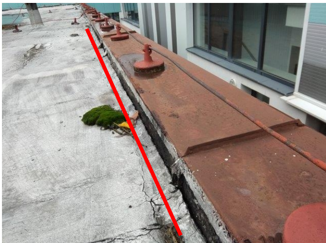
foto /18/ Pohled na netěsnost podél atiky, zkorodovaná atika a bleskosvodná soustava
