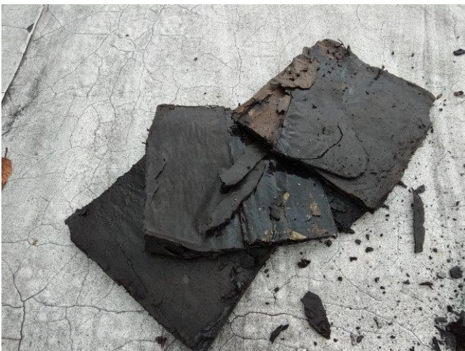
foto /6/ Pohled krytinu z několika nesoudržných asfaltových pásů
