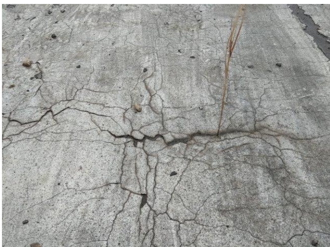
foto /14/ Pohled na popraskaný vrchní asfaltový pás, prorůstání pásu náletovou zelení
