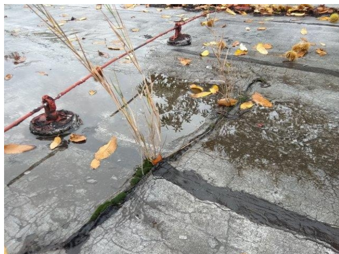
foto /15/ Pohled na popraskaný vrchní asfaltový pás, prorůstání pásu náletovou zelení v prostoru louže
