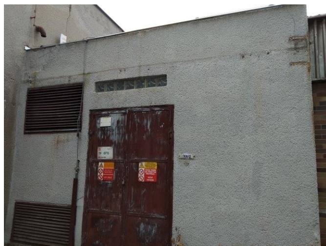
foto /23/ Pohled na trafo stanici
