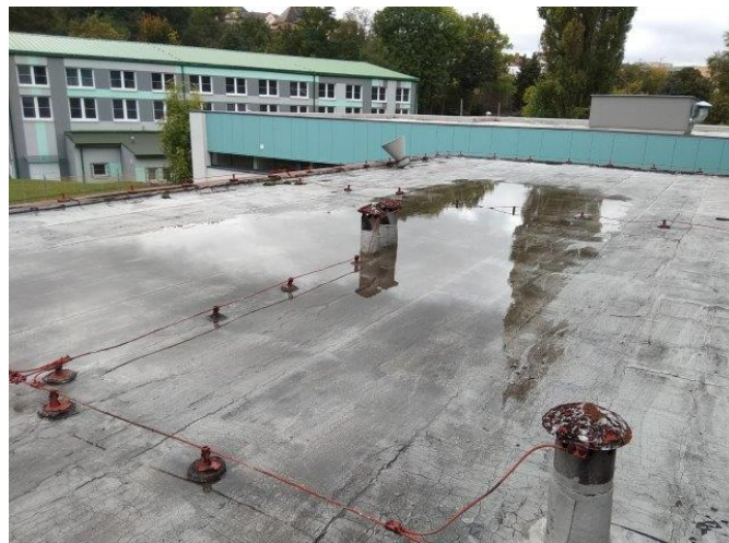
foto /19/ Pohled na louži na střeše v místě ucpaného střešního vtoku
