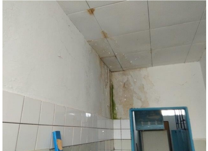
foto /5/ Pohled na vlhkostní poruchy v interiéru šaten
