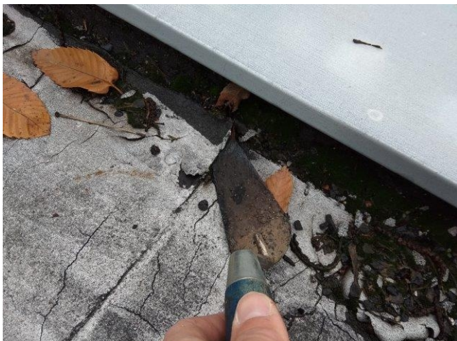
foto /12/ Pohled na netěsnost ve spoji krytiny
