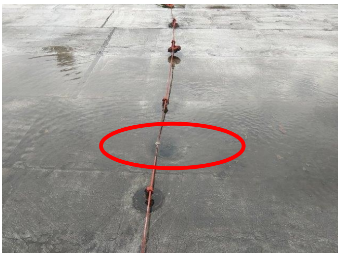
foto /20/ Pohled na ucpaný vtok
