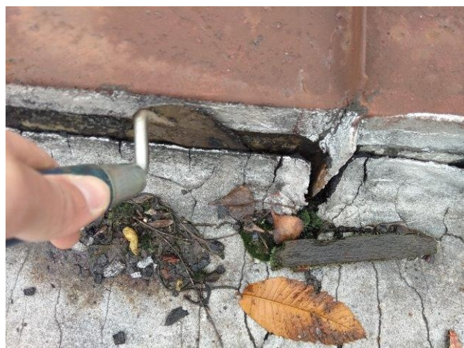
foto /17/ Pohled na netěsnost napojení krytiny na atiku
