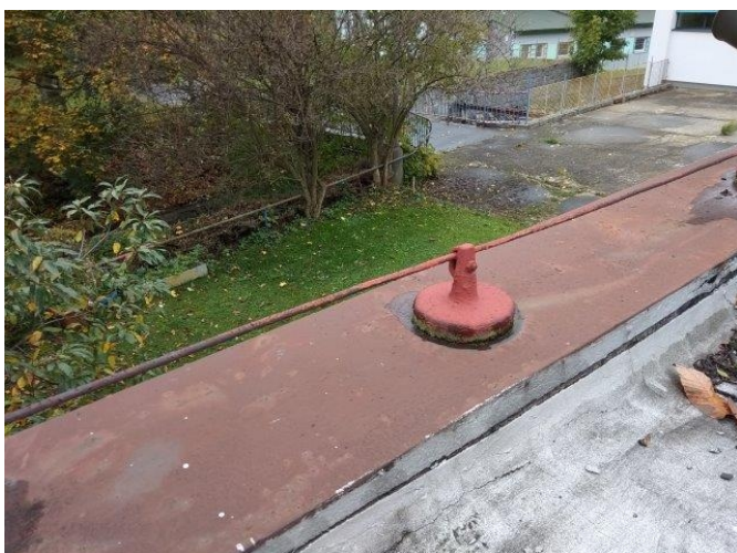
foto /16/ Pohled na zkorodované oplechování atiky a bleskosvodné soustavy
