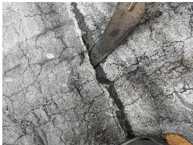
foto /11/ Pohled na netěsnost ve spoji krytiny, praskliny v nátěru a vrchní hydroizolační vrstvě
