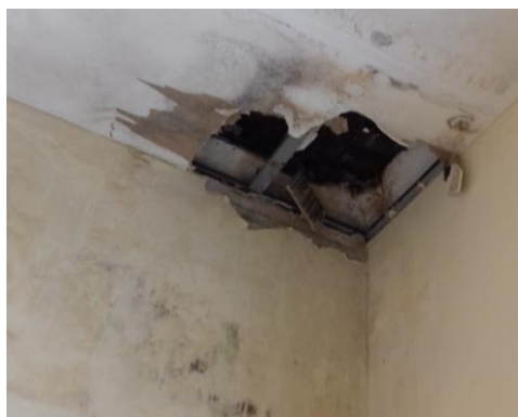
Lokální propad stropu nad 2.NP
