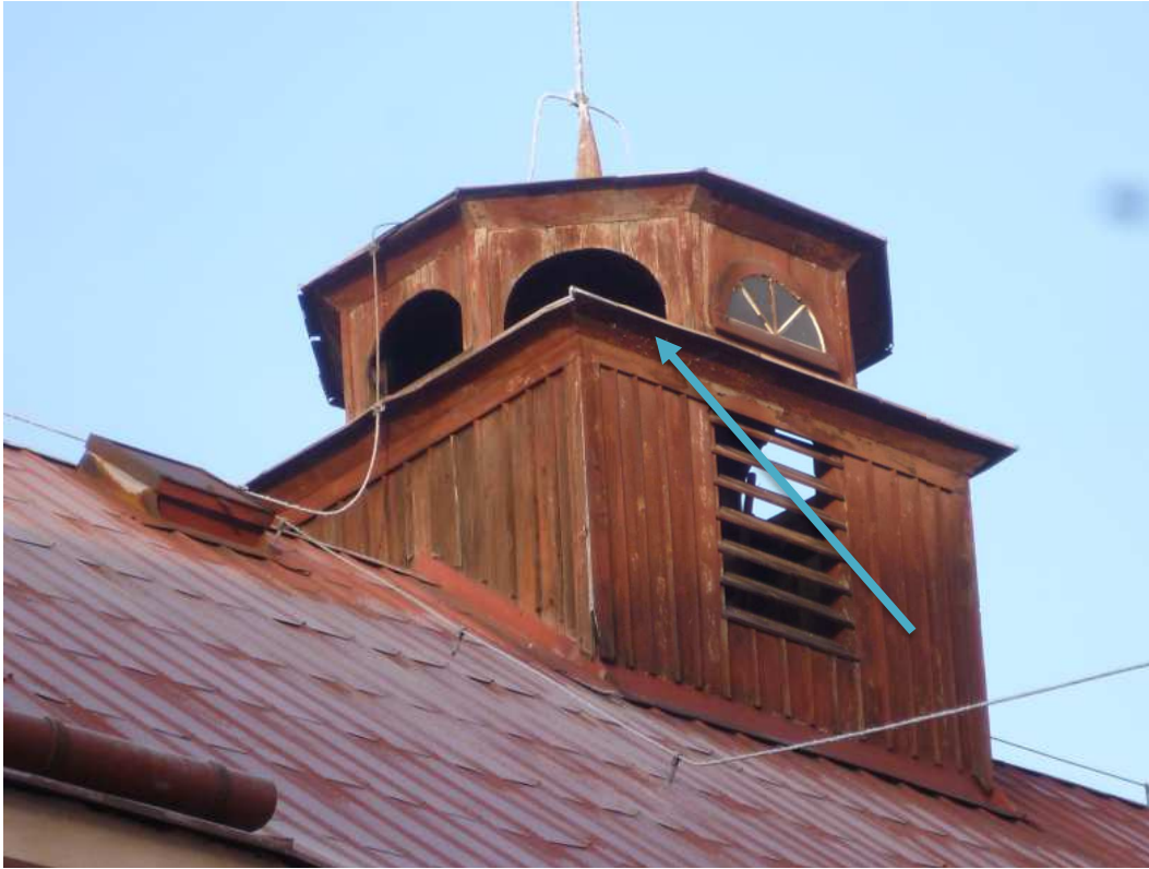
Pozn. 7 - výměna poškozeného dřevěného prvku šikmého pobití římsy mezi čtvercovou a osmistěnnou částí, předpoklad 50%
