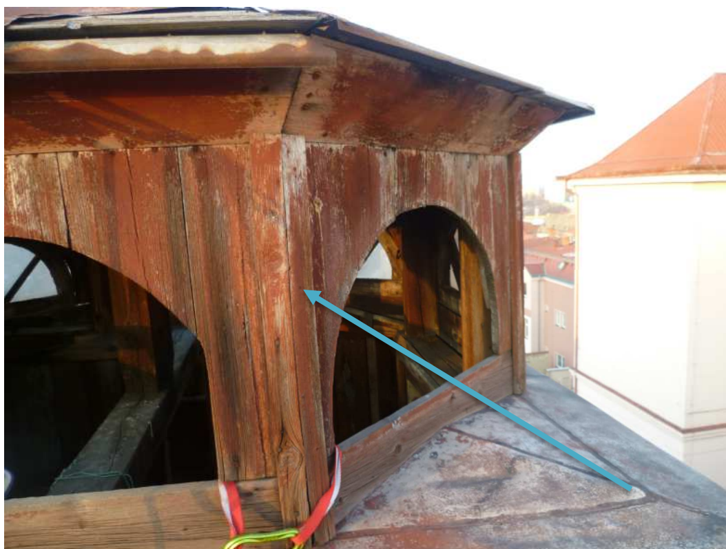
Pozn. 4 - výměna poškozeného dřevěného prvku svislého pobití hran osmistěnnu, předpoklad 100%
