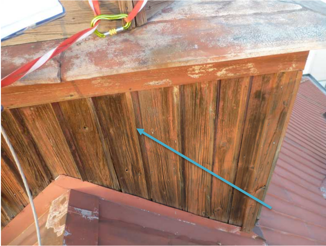
Pozn. 9 - výměna poškozeného dřevěného zdobného prvku trojúhelníkového tvaru, předpoklad 25%
