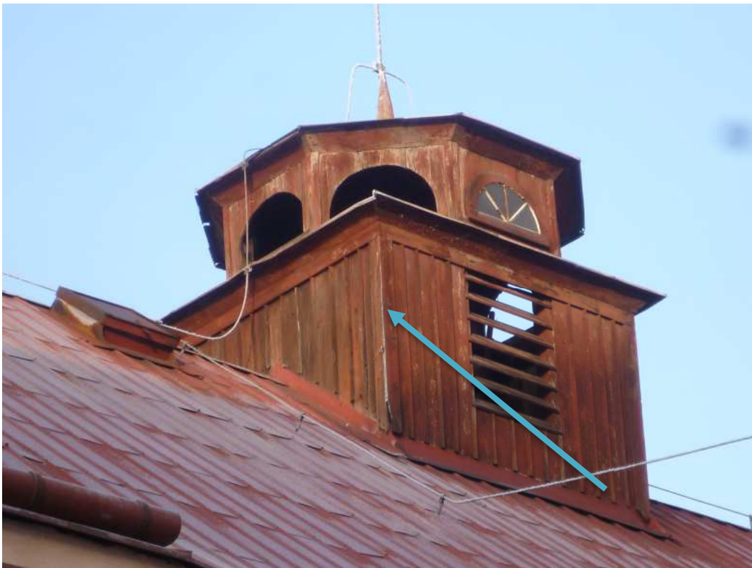
Pozn.12 - výměna poškozeného dřevěného prvku pobití hran nárožní čtvercové nadstřešní části. Předpoklad 100%
