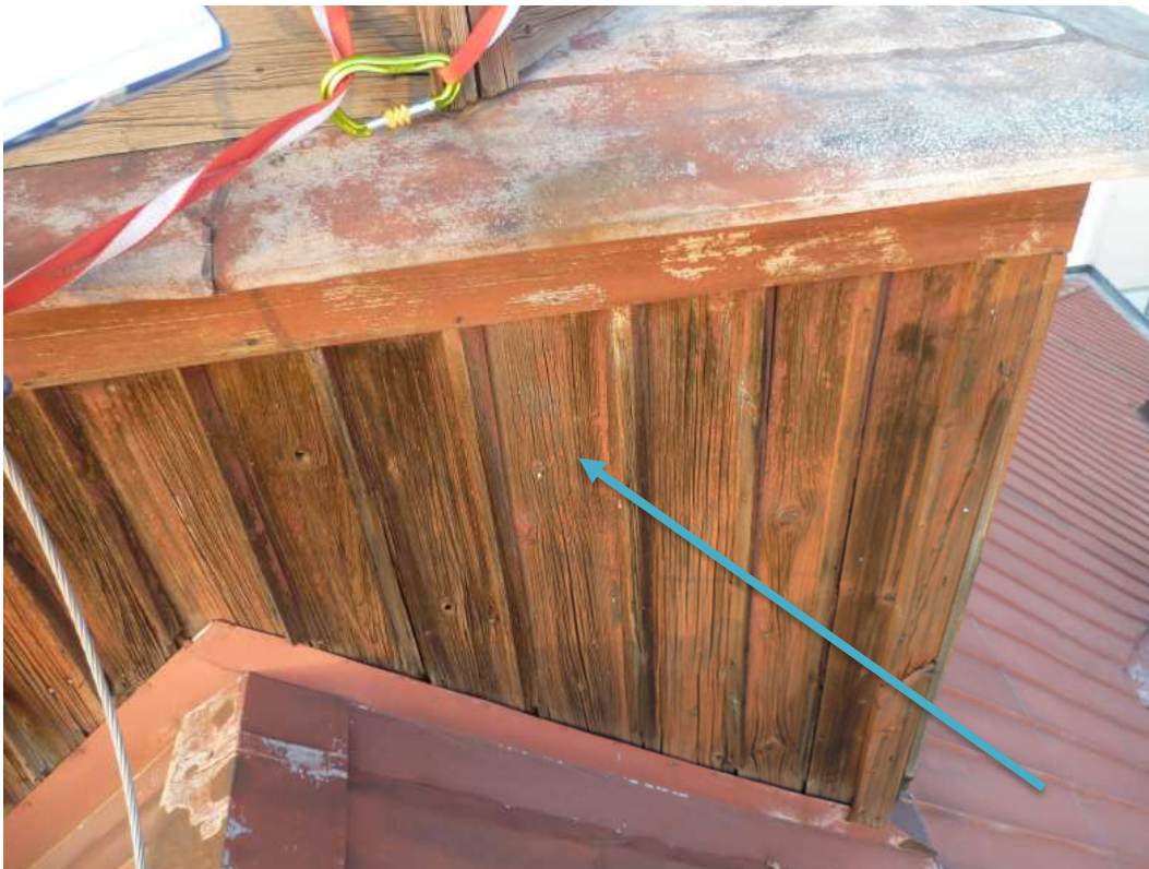
Pozn.10 - výměna poškozeného dřevěného prvku opláštění čtvercové nadstřešní části věžičky, předpoklad 25%
