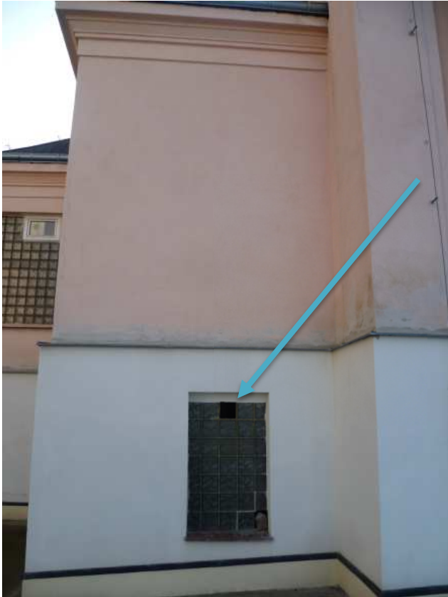
Pozn.85 - osadit novou kovovou mřížku do sklobetonových tvárnic (v rámci jedné skleněné tvárnice).
