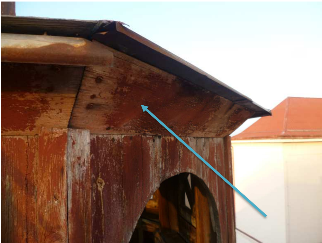
Pozn.52 - nové dřevěné šikmé pobití mezi osmistěnnou částí a střechou z prken tl. cca 18 – 20 mm
