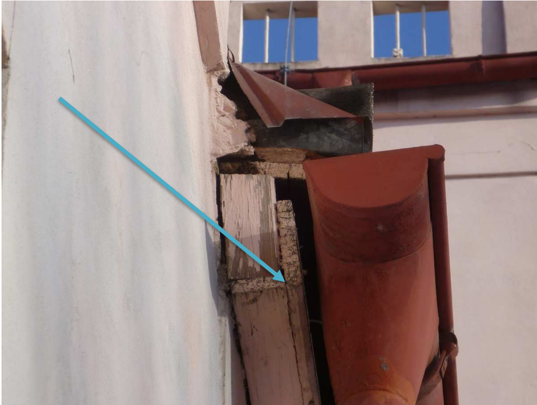
Pozn.69 - montáž nových dřevěných prken podokapní římsy viz detail římsa 2. Dřevěné prvky budou ohoblovány a obroušeny a natřeny bezbarvou impregnací proti houbám, plísním a dřevokazným škůdcům (např. Lignofix, Bochemit). Dřevěné prvky budou z venkovní strany opatřeny barevným nátěrem (lazurou) v barvě dle investora a odboru památkové péče.
