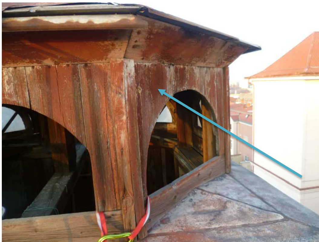
Pozn. 3 - výměna poškozeného dřevěného prvku pobití osmistěnné části věžičky, předpoklad 100%
