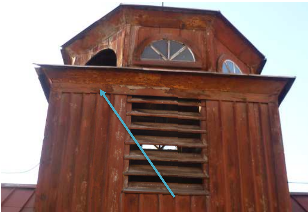
Pozn.58 - částečná výměna poškozeného vodorovného pobití čtvercové nadstřešní části z prken tl. cca 18 - 20 mm
