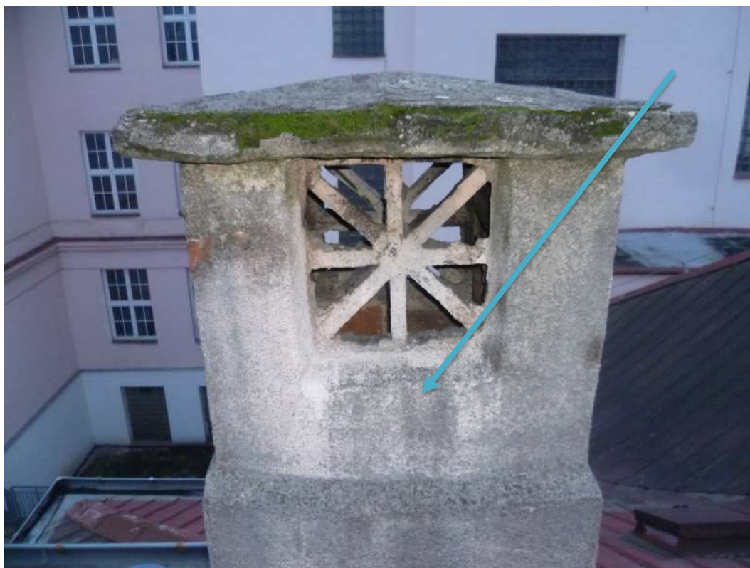
Pozn.41 - odstranit veškeré narušené a nesoudržné omítky. Předpoklad je cca 20%.
