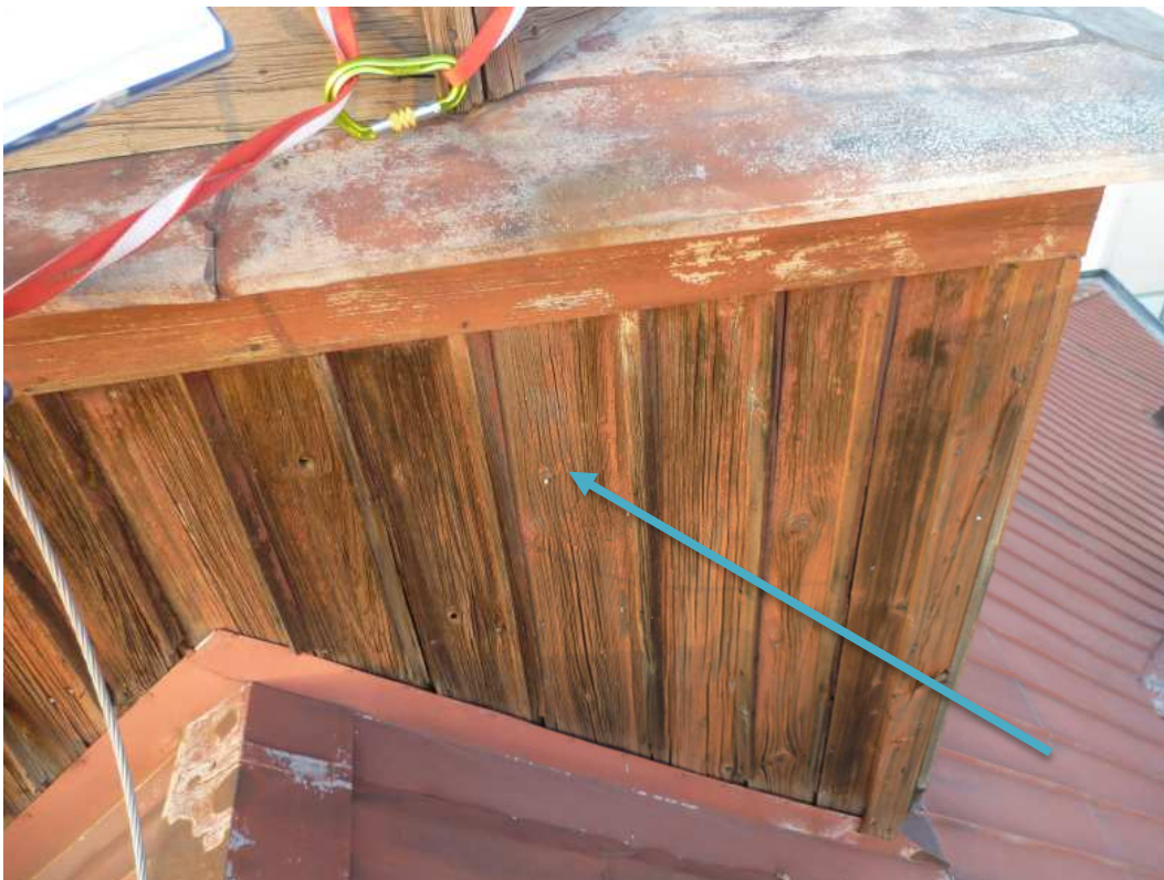
Pozn.60 - částečná výměna opláštění čtvercové nadstřešní části věžičky z prken tl. cca 18 - 20 mm
