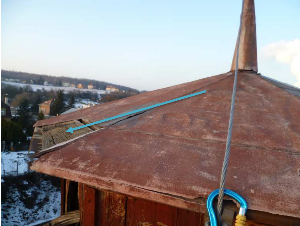
Pozn. 1 - výměna poškozeného dřevěného prvku střešního pobití, předpoklad 100%
