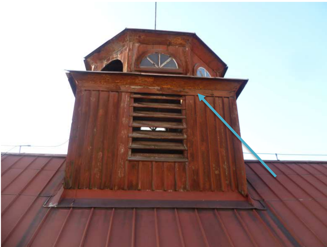
Pozn. 8 - výměna poškozeného dřevěného prvku vodorovného pobití čtvercové nadstřešní části, předpoklad 50%
