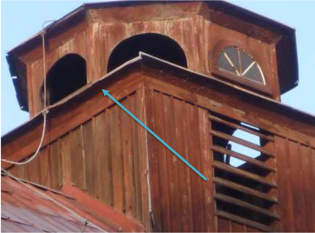
Pozn.57 - částečná výměna poškozeného šikmého podbití římsy mezi čtvercovou a osmistěnnou částí z prken tl. cca 18 - 20 mm
