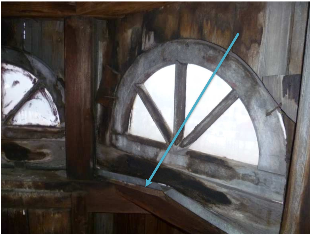
Pozn. 6 - výměna poškozeného dřevěného prvku části parapetu pod okny, předpoklad 75%
