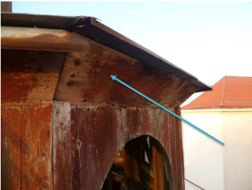
Pozn. 2 - výměna poškozeného dřevěného prvku šikmého pobití mezi osmistěnnou částí a střechou, předpoklad 100%
