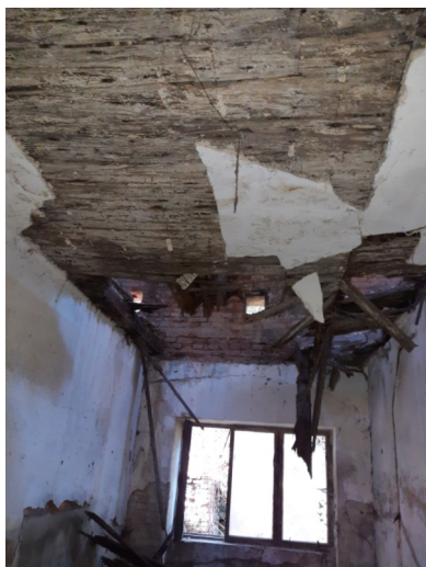
foto/31/ Propadlé stropy objekt č. 2
