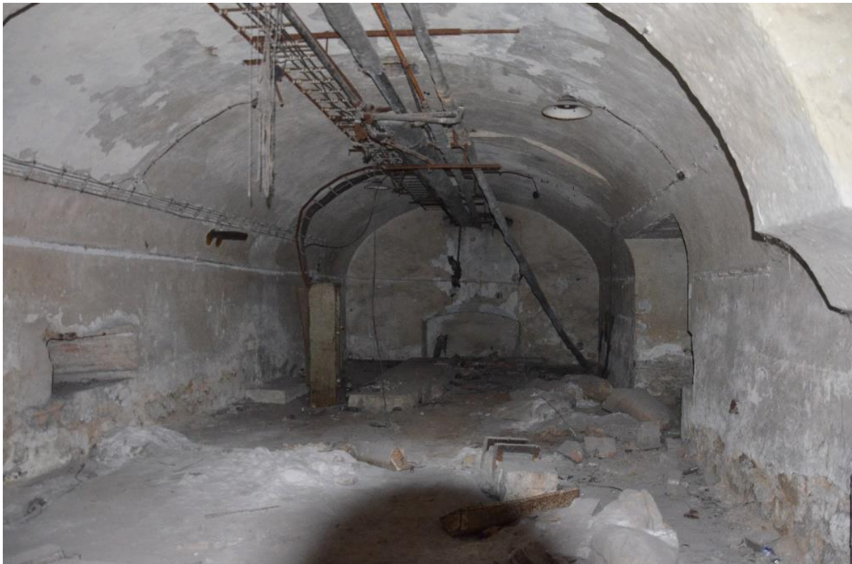
č.p. 2, sklepní oddělení, na stropě zbytky instalací a rozvodů
