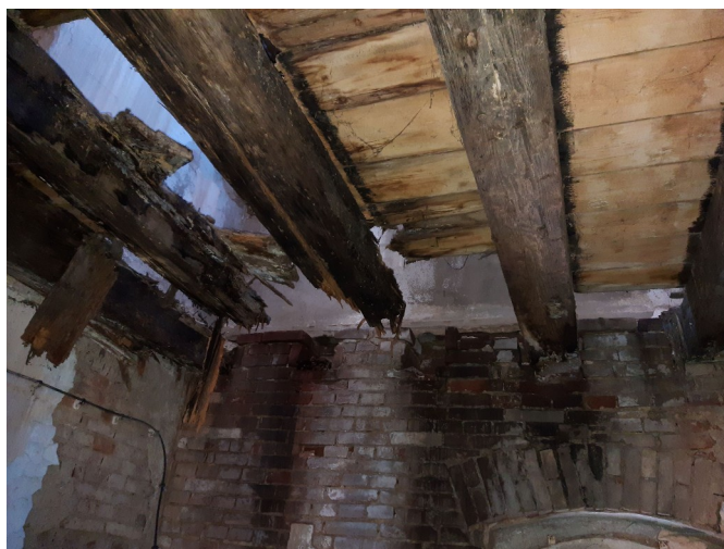
foto/34/ Propadlé stropy objekt č. 228
