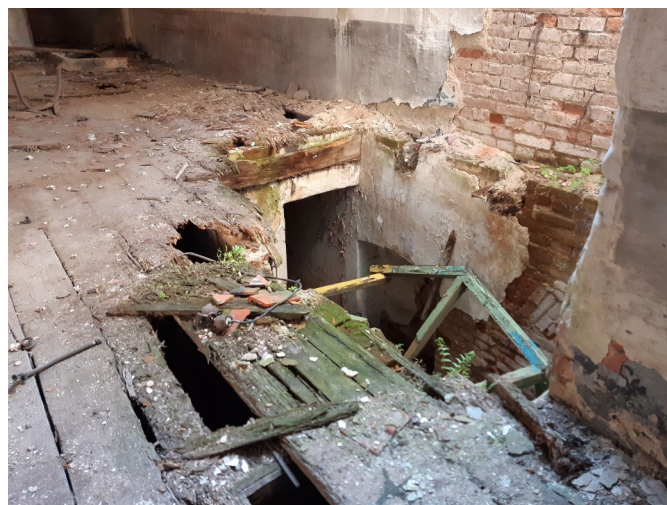
foto/38/ Propadlé stropy objekt č. 228
