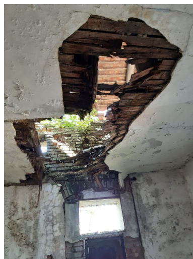
foto/30/ Propadlé stropy objekt č. 2
