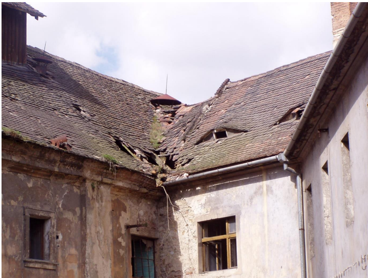
Poškození střech, úžlabí č.p.1 a č.p. 228
