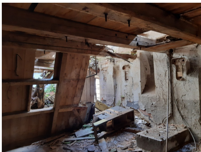
foto/36/ Propadlé stropy objekt č. 228
