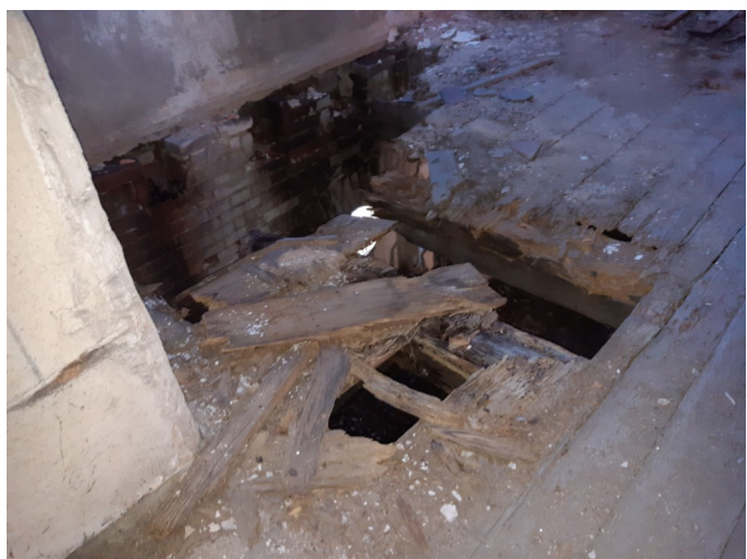
foto/35/ Propadlé stropy objekt č. 228
