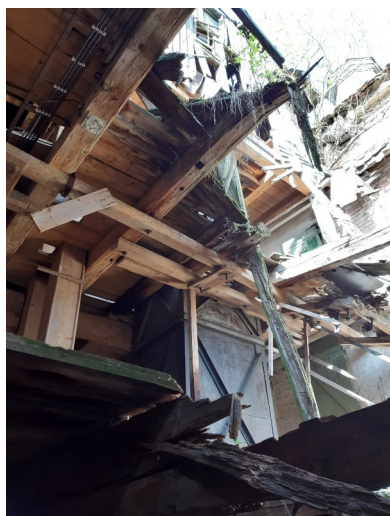
foto/37/ Propadlé stropy objekt č. 228
