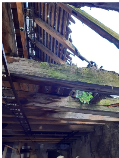
foto/39/ Propadlé stropy objekt č. 228
