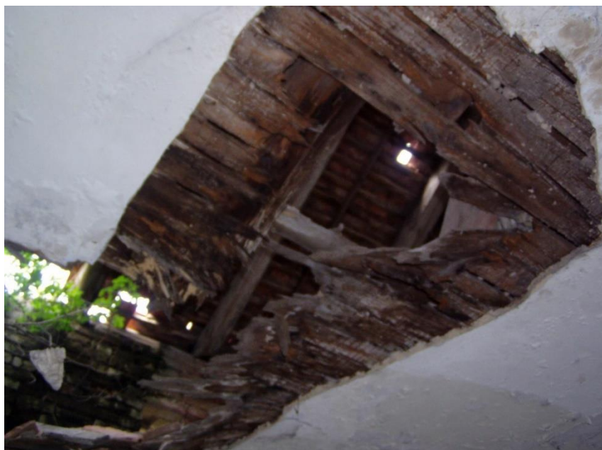
č.p.2 průhled propadlým stropem na porušený střešní plášť
