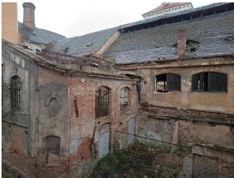
Poškození střešního pláště
