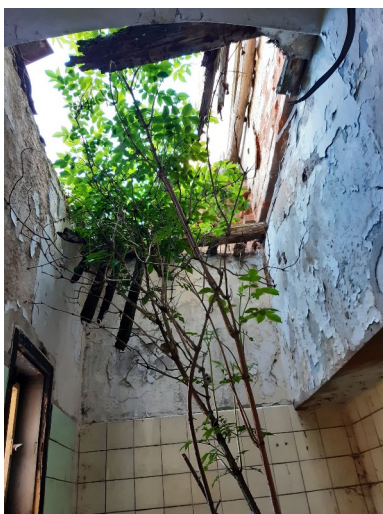
foto/29/ Propadlé stropy objekt č. 2
