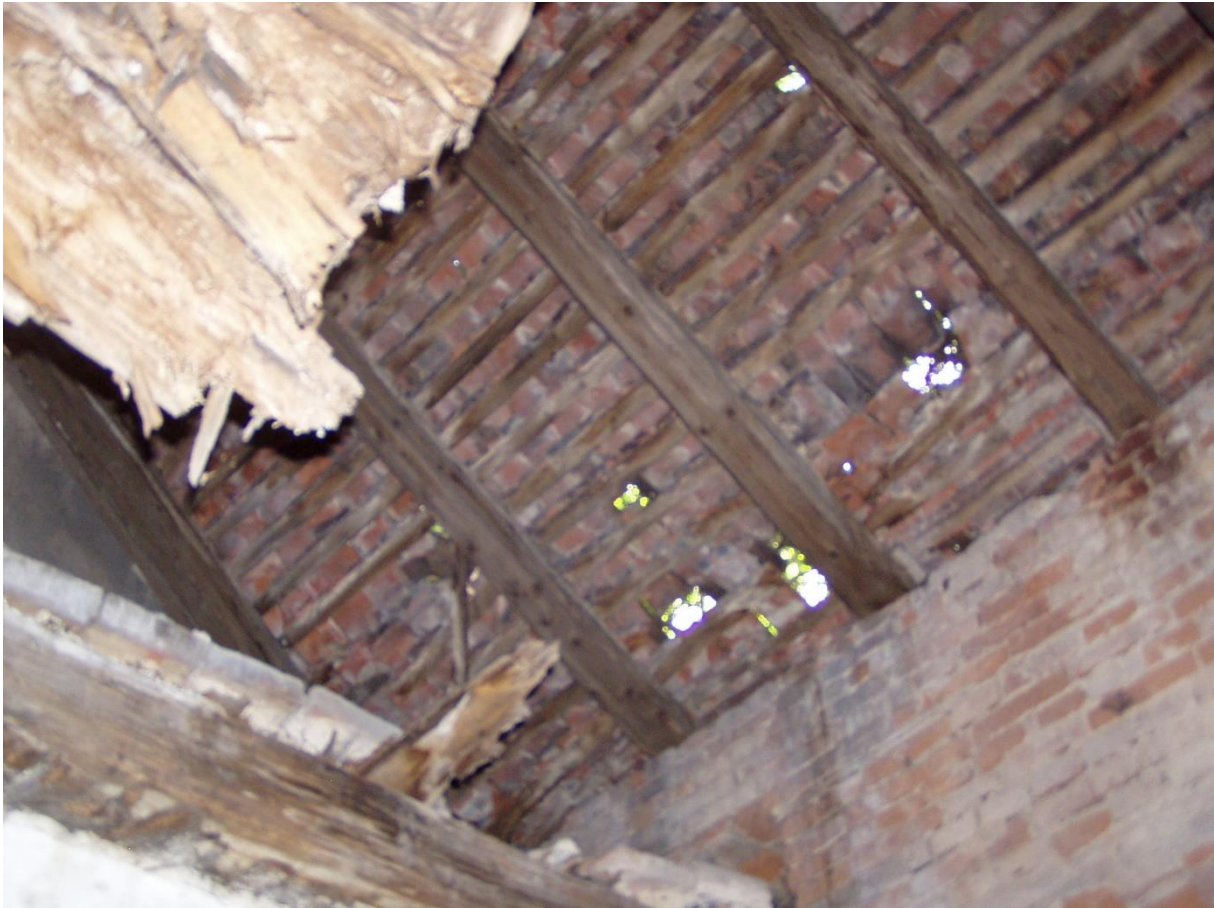
č.p. 2, poruchy střešního pláště
