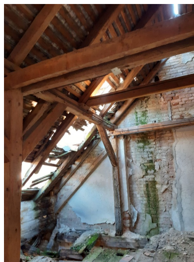
foto/40/ Pohled na narušený střešní plášť na objektu č. 228
