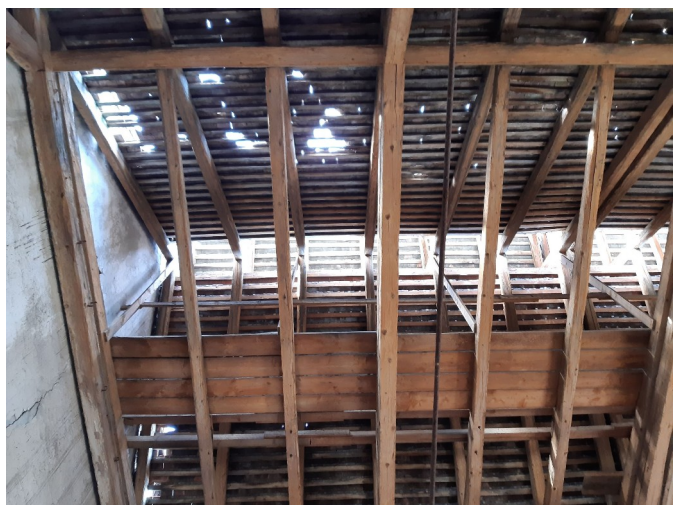
foto/33/ Pohled na narušený střešní plášť – chybějící krytina na objektu č. 228
