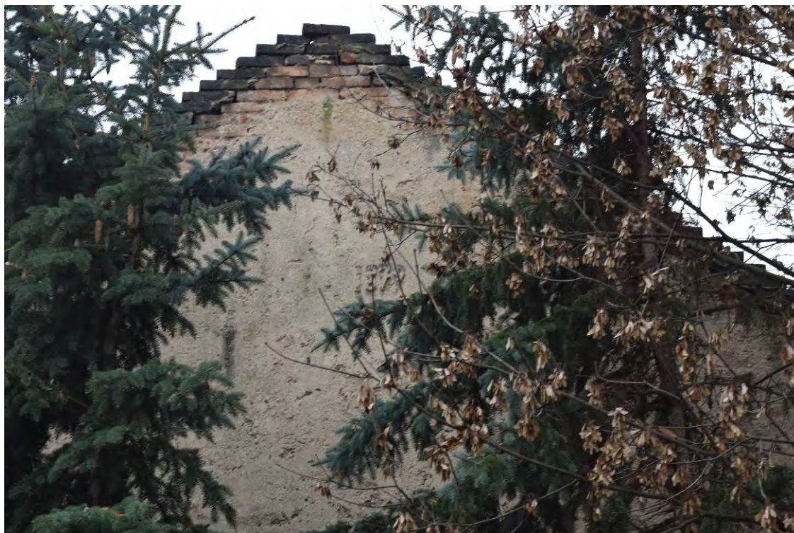
19 , detail východního štítu č.p. 228 části III s letopočtem 1879 vztahujícím se zřejmě k dokončení této části.
