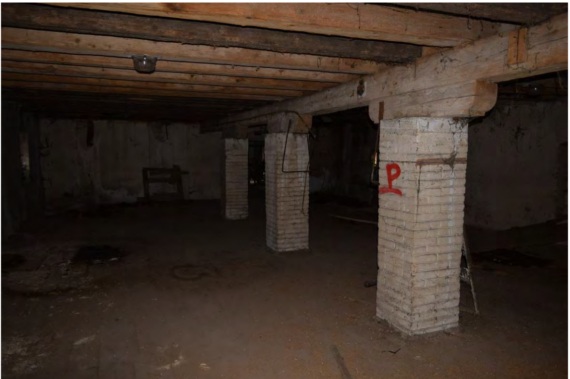
52, pohled do prostoru 2.4 směrem k severovýchodu. Středový průvlak podpíraly původně dřevěné trámy, které později nahradily zděné.
