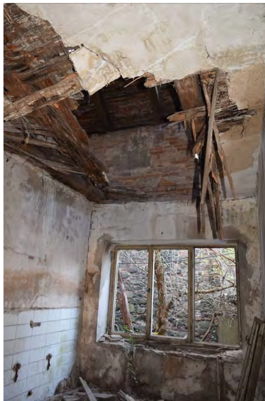
61, pohled na částečně zřícený strop prostoru 2.10 .
