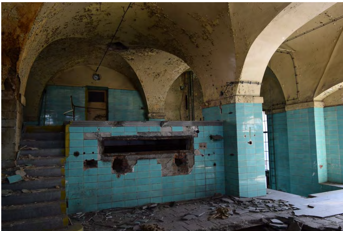
49, pohled do prostoru 2.1 směrem k jihozápadu. Klenba spočívá na mohutných pilířích. Obložení zelenomodrými kachlemi pochází z poslední úpravy provedené ve 30. letech 20. stol.
