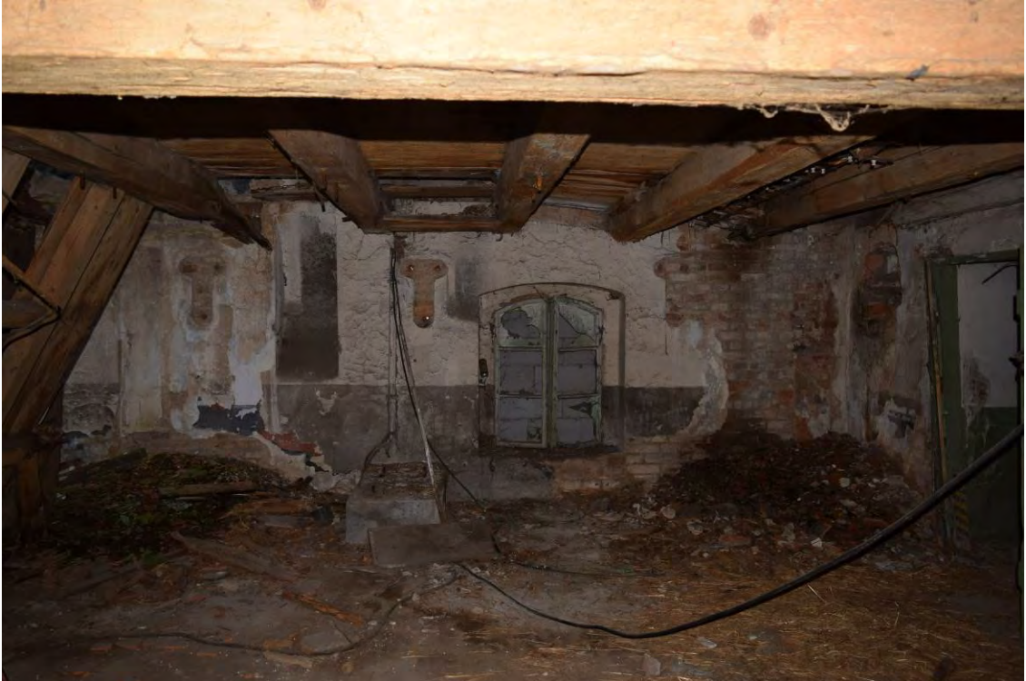
53, pohled do prostoru 2.7 směrem k severovýchodu. Snímek dobře ukazuje havarijní stav horizontálních dřevěných konstrukcí.
