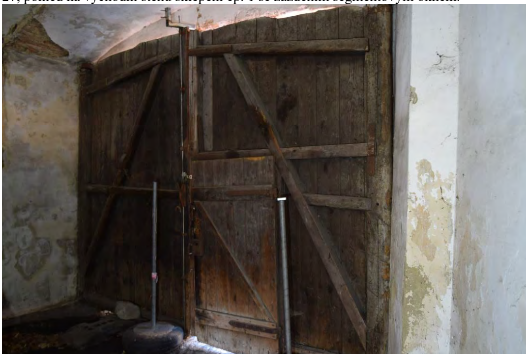
28, pohled na vnitřní stranu dvoukřídlým dřevěným vrat svlakové konstrukce se vstupem. Vrata mají na vnější straně členění ve formě slunce přes celou plochu. Prostor 1.1.
