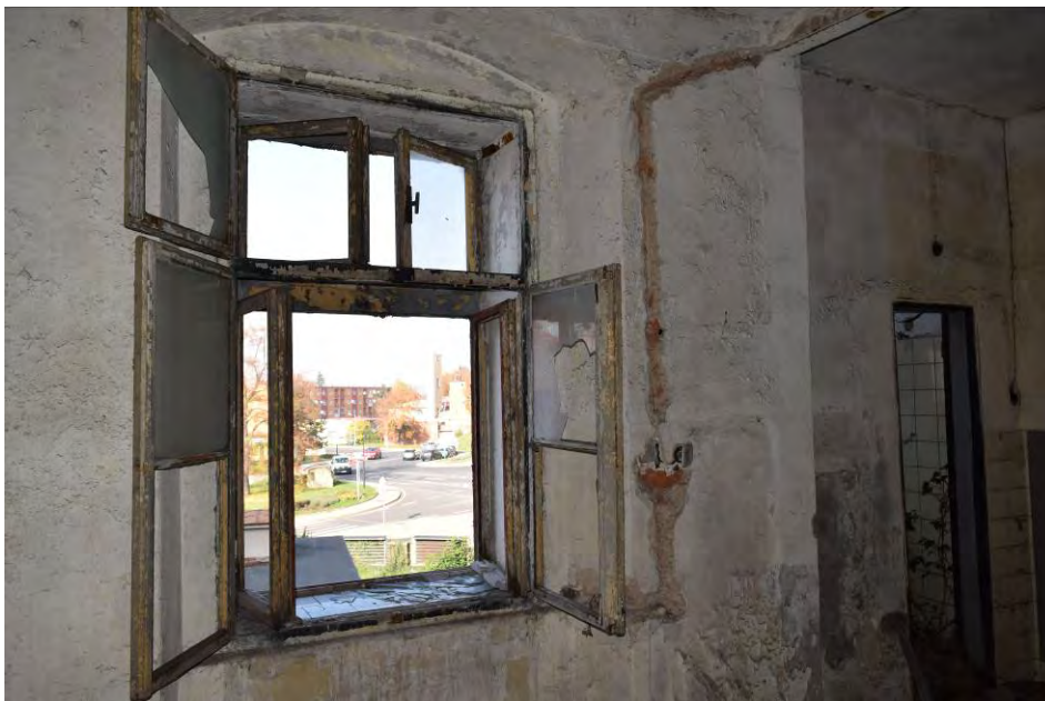
60 , detail okna v severozápadní stěně prostoru 2.7 . Okno je jedním z mála původních z doby výstavby.
